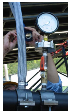
写真-4 圧力計及び排気用ホース
