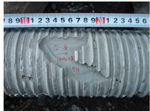
写真-5 グラウト未充填箇所
