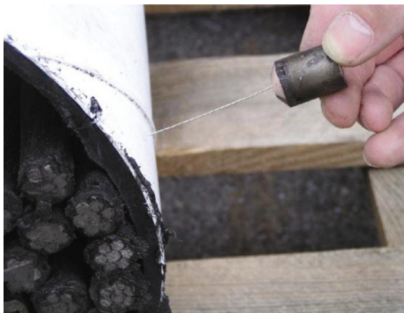
図 2 : ダクト内の 1 本のストランドと結ばれた
