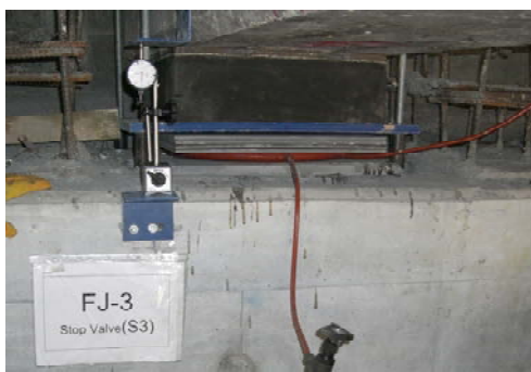
写真-5 オルタキョイ高架橋のゴム沓とフラットジャッキ
