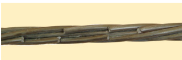
写真-4 数箇所の素線破断が見られた PC 鋼より線
